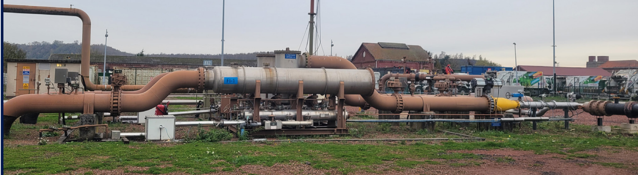
Site de captage de chaleur du réseau d'Avion (puits minier)
